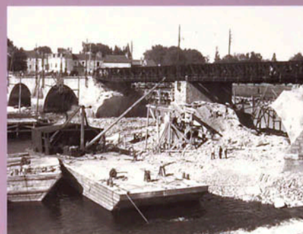
Pont de Pirmil détruit. Une passerelle flottante pour piétons est mise en place en septembre 1944. Longue de 300 mètres et large de 2 mètres, elle enregistre de véritables embouteillages aux heures d'affluence, correspondant à l'embauche et à la débauche des usines.
